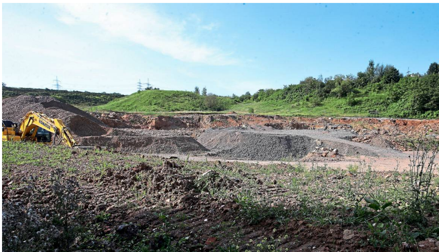
Auf dem alten Ziegelei-Gelände kann's jetzt losgehen mit dem Bau der Luisen-Höfe.
